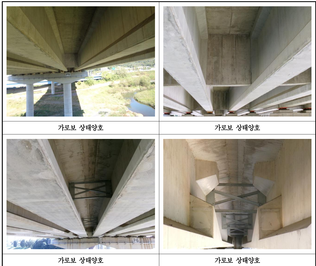
【사진 35.3.7】 가로보 손상현황
